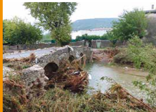
Le pont de Saint Hippolyte-du-Fort après les crues dévastatrices de 2014
